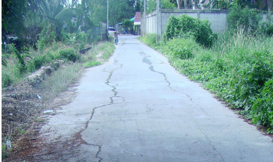
รูปที่ 2.35 ความเสียหายผิวทางคอนกรีตประเภทแผ่นคอนกรีตเสียหายทั้งแผ่น
