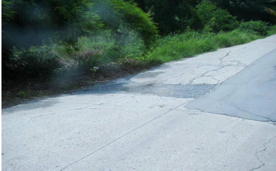
รูปที่ 2.33 ความเสียหายผิวทางคอนกรีตประเภทแผ่นคอนกรีตหลุดตัว
