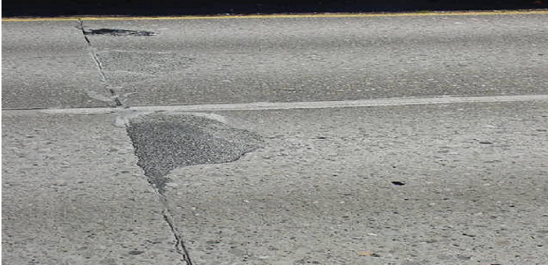
รูปที่ 2.31 ความเสียหายผิวทางคอนกรีตประเภทรอยปะซ่อมที่เสียหาย
